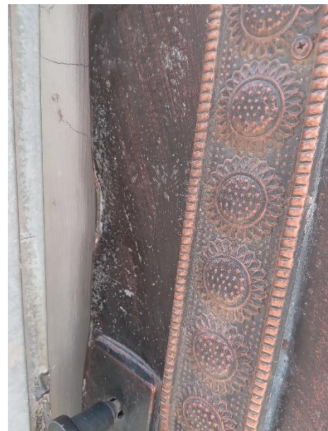
Das Türschloss wurde aufgesprengt. Die Tür schließt jetzt nicht mehr.
